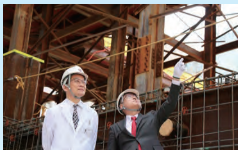
工事現場の最下層で進捗を確認する竹原敬郎病院長(左)と木村正病院長補佐
