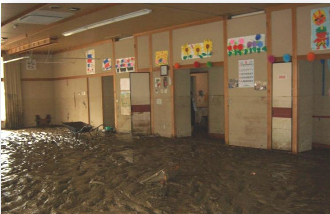
老人福祉センターの被害（上月区） 保育園が直撃を受け被害を軽減してくれた
