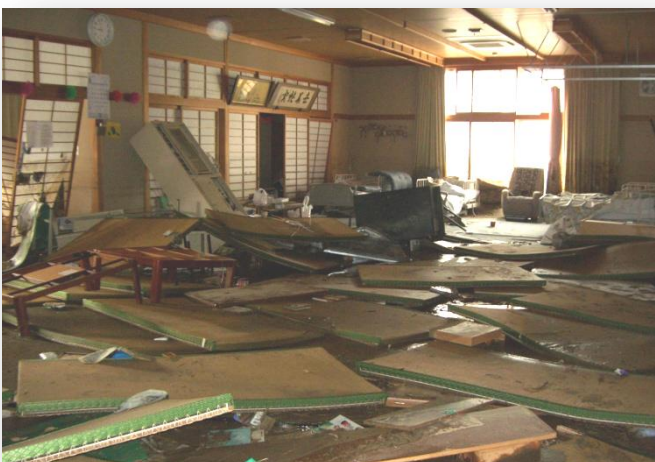
老人福祉センターの被害（上月区）
