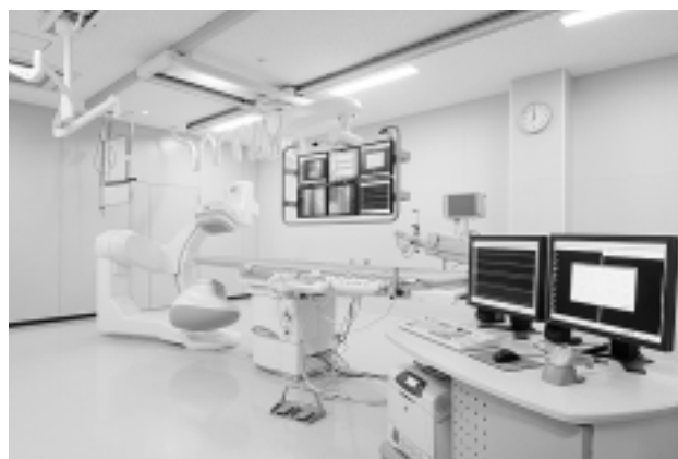
GE側血管撮影室
