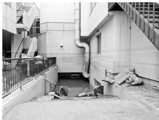
写真1 地下部分が冠水した病院施設
