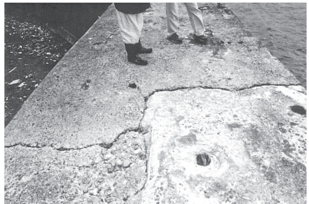
写真5 護岸の亀裂状況（その一例、護岸天端にて撮影）
