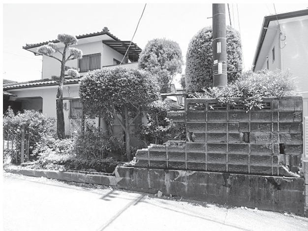
写真2 倒壊したブロック塀
