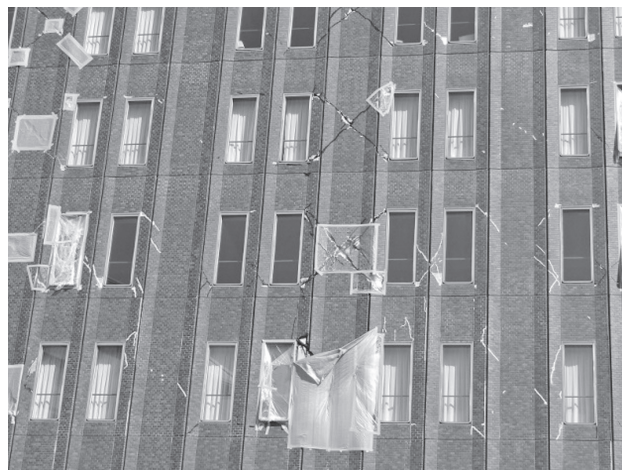
写真3 せん断跡が見られる建物
