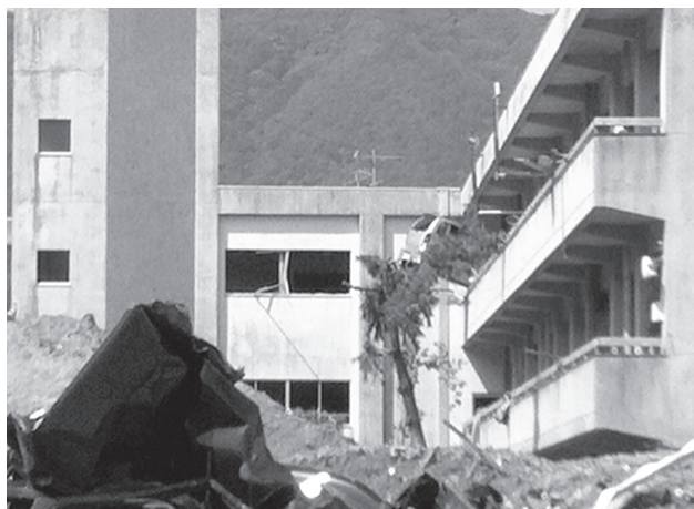
写真6：鶴住居小学校校舎（平成23年5月）
