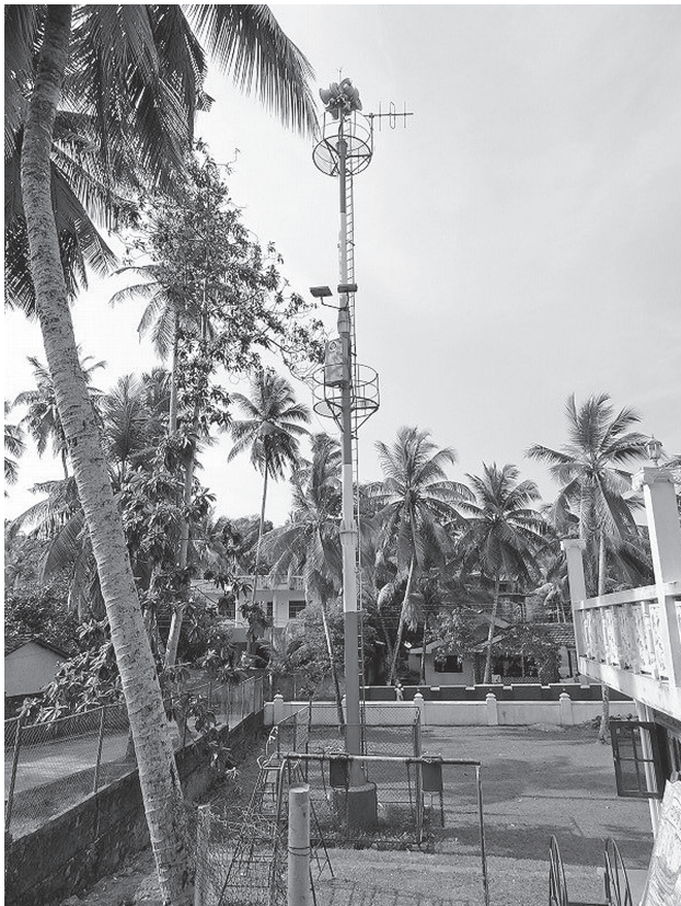
写真1 カルタラ県の寺院に設置されている防災放送塔
