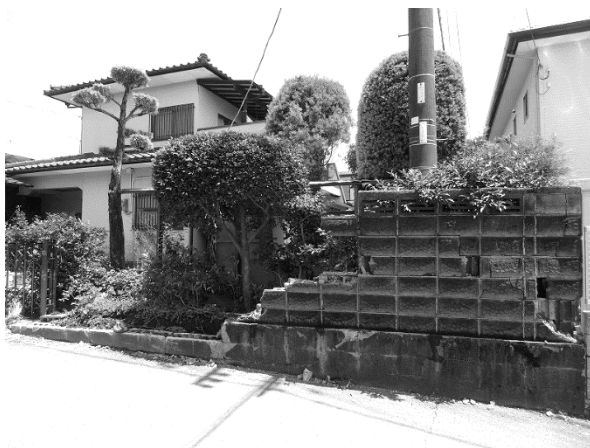
写真1 倒壊したブロック塀
