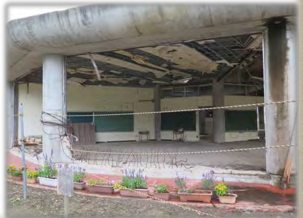
教室の壁は全てなくなっている
